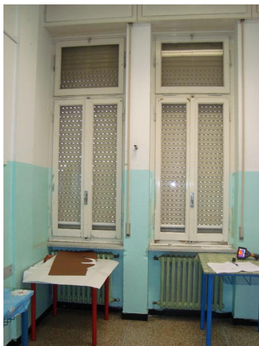
Figura 4.6 – Particolare radiatore su parete esterna – scuola elementare
