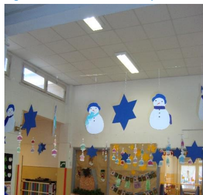
Figura 4.15 - Particolare corpi illuminanti aule
