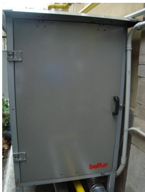
Figura 4.12 - Particolare generatore di calore
