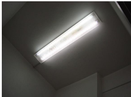
Figura 4.16 - Particolare dei corpi illuminanti ubicati nella mensa
